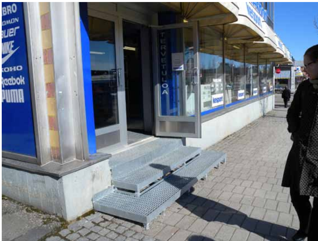
Kuva 1. Keskusta-alueen liikkeiden sisäänkäynneissä on paljon esteettömyyspuutteita. Useisiin liikkeisiin on esim. pyörätuolilla mahdotonta päästä edes avustajan kanssa.
